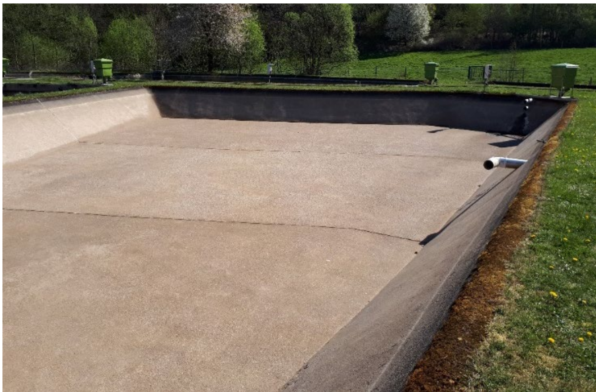
Abbildung 21: Brachliegender Betonteich in einer Fischzucht aufgrund zu geringer Wasserführung des Vorfluters im Sommer und starker Erwärmung des Haltungswassers durch fehlende Beschattung (Foto: Cornelius Becke, LANUV)
