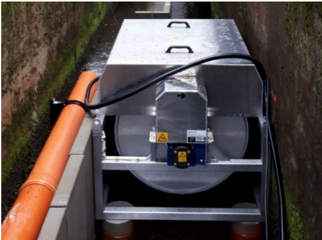
Abbildung 12: Trommelfilter im Ablaufgraben einer Aquakulturanlage (Foto: Cornelius Becke, LANUV)
